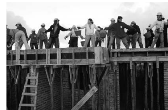
La ville vivante. Coopérative de logements à Montevideo / Crédit photo : Benjamin Nahoum
